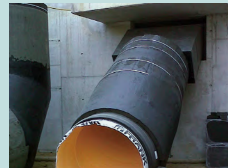
Isoliertes Lüftungsrohr mit Übergang auf rechteckigen Gebäudeanschluss
