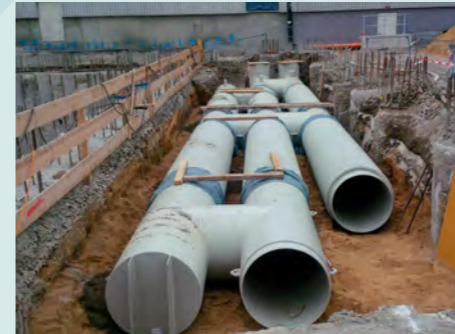
Stauraumbehälter inkl. Verbindungen aus PP
