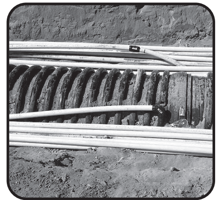
Einfacher Anschluss der Anbindeleitungen mit Heizwendelschweißmuffe
