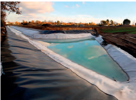
Offener Düker mit Absatzbecken; mit FRANK BVR 9000 HP als stabile Schutz- und Verschleißlage auf Kunststoffdichtungsbahn.
